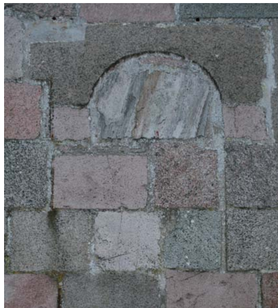
Fig. 43. Blændet oprindeligt vindue østligt på skibets nordside (s. 1094). Foto Hugo Johannsen 2010. – Verblendetes ursprüngliches Fenster östlich der Nordseite des Schiffes.
